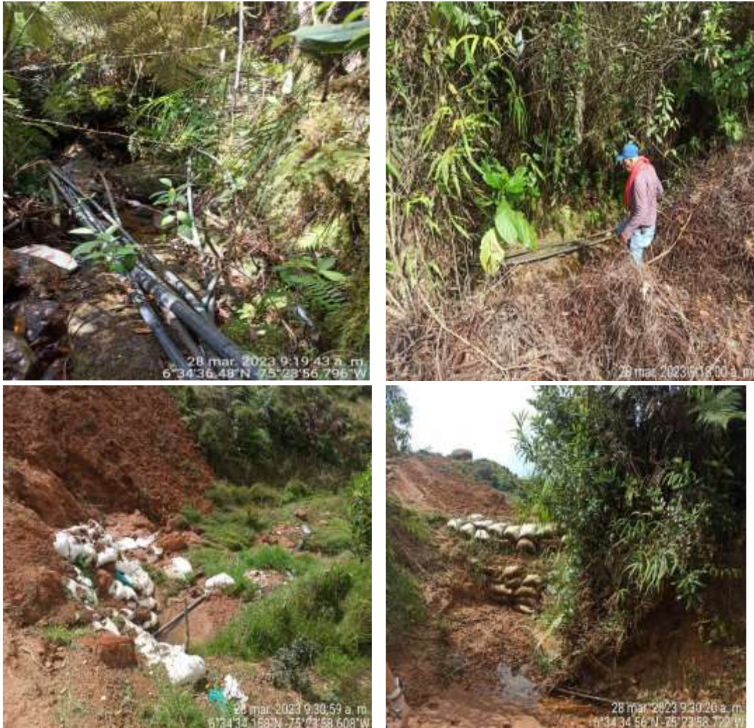
Fotografías 9 a 14. Remoción de cobertura de protección sobre afluente de la quebrada Las Ánimas y construcción de terraplén con interrupción del flujo natural de la fuente.
