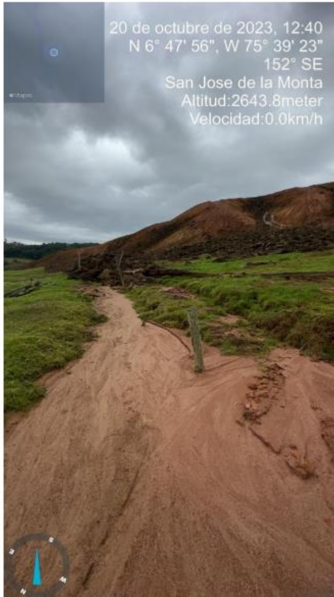
Foto 4.proceso de erosión cerca fuente hídrica.
