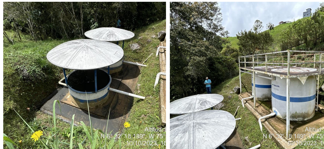
Fotografía 1,2. Lechos de secado y PTARD Bellavista N° 1 del municipio de Donmatías.
