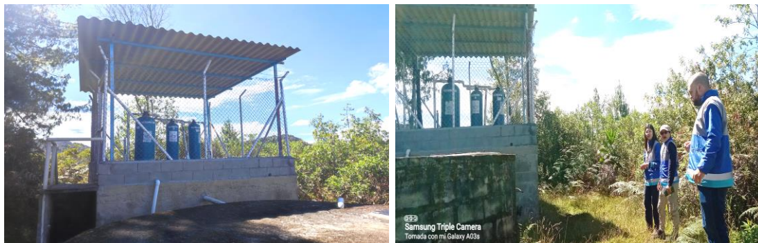
Foto 11 y Foto 12: Filtros y tanque de almacenamiento del Acueducto veredal remanso de paz
