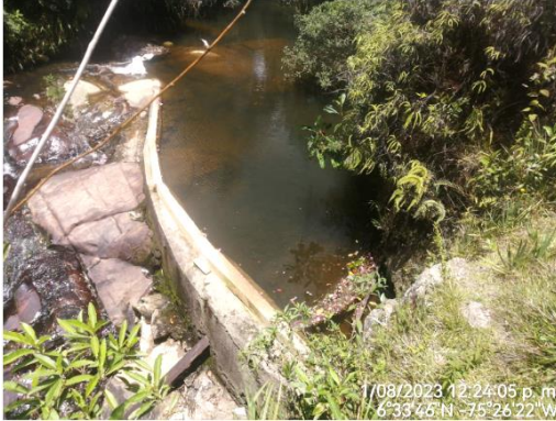
Foto 17: Bocatoma lateral con rejilla sobre la Q. Orobajo
