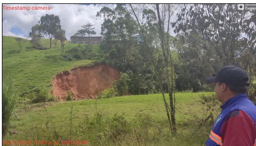
Registro 31. Proceso erosivo que se está presentando en el talud inferior en la margen derecha de la quebrada Las Ánimas, en inmediaciones de la Institución educativa Rural Benilda Valencia. Fuente: Propia.
