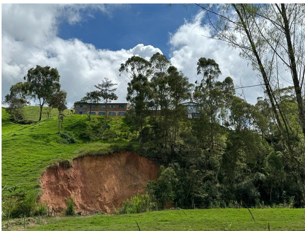
Registro 29. Proceso erosivo que se está presentando en el talud inferior en la margen derecha de la quebrada Las Ánimas, en inmediaciones de la Institución educativa Rural Benilda Valencia. Fuente: Propia.
