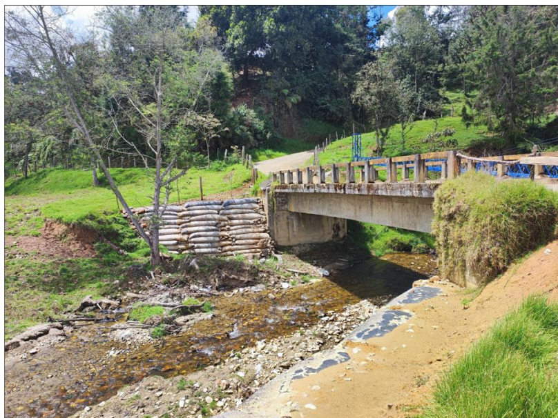
Foto 1: Puente sobre la quebrada La Montoya, la cual ha sido afectada por crecientes de esa fuente hídrica.
