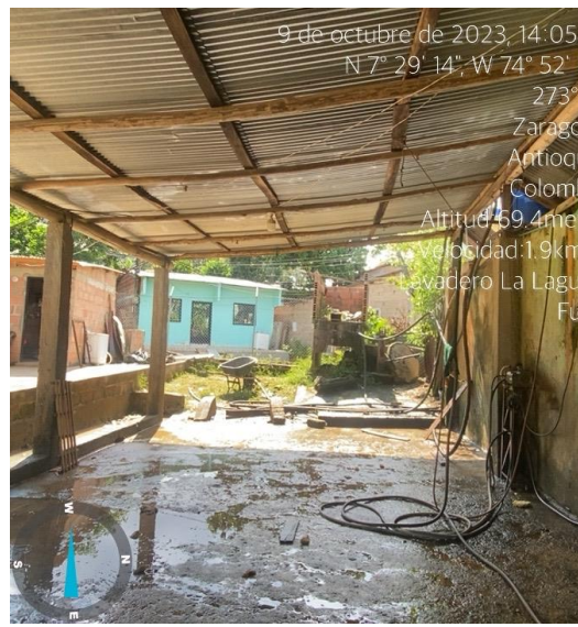
Evidencias de fuga en el lavadero
