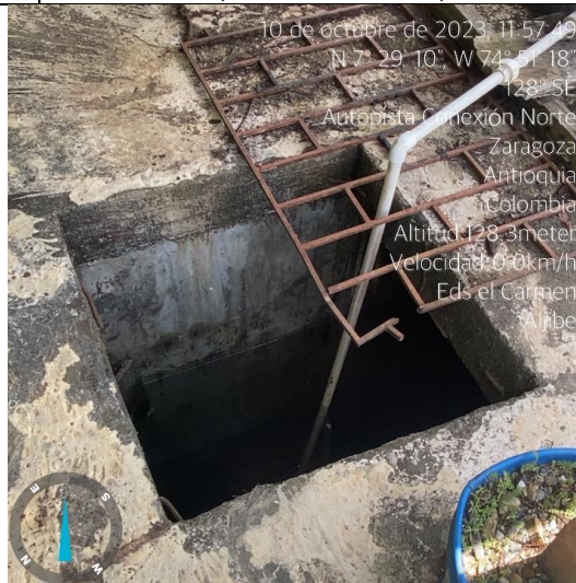
Poceta de almacenamiento de aguas lluvias.
