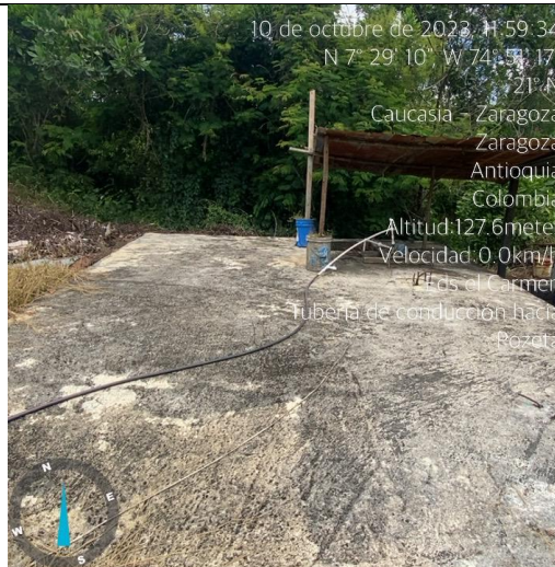
Tubería de conducción aguas lluvias
