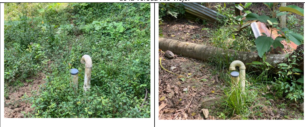
Fotografía 13 y 4. Sistemas sépticos sin mantenimiento.
