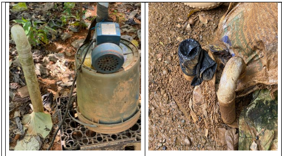
Fotografía 33 y 4. Sistemas sépticos sin mantenimiento.
