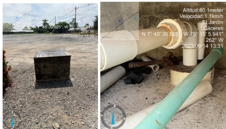
Foto 20. Infraestructura del pozo profundo y vista interior.
