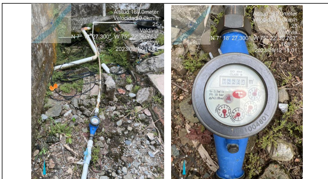
Foto 9. Micromedidor o contador de consumo instalado.
