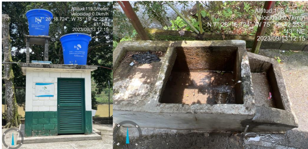
Foto 16. Sistema de potabilización sin uso y poceta de recepción de agua.
