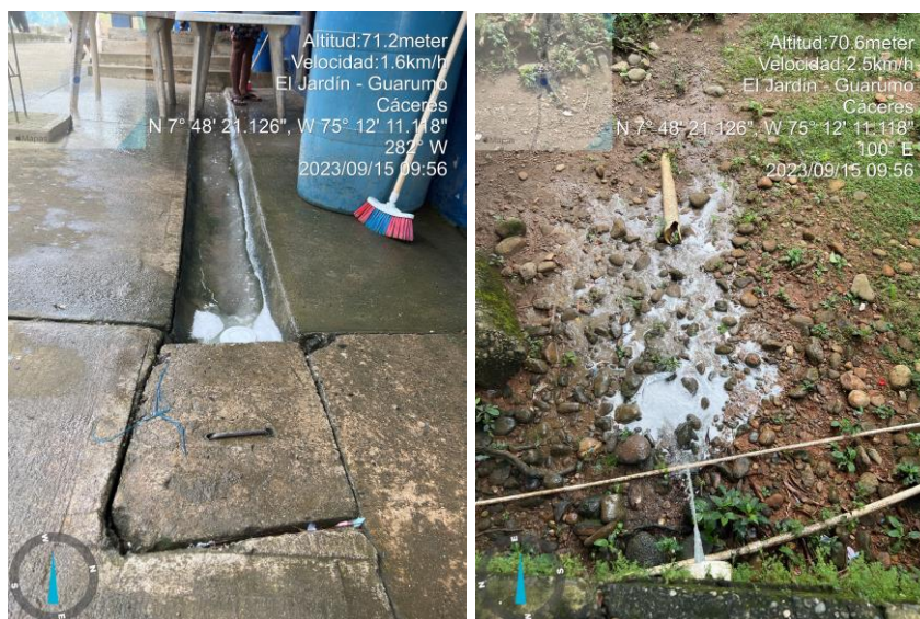
Foto 22. Aguas grises servidas y descarga a cielo abierto.
