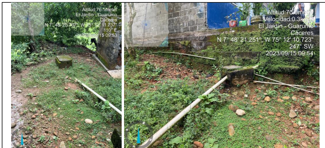
Foto 21. Ubicación de los Sistemas de cajas de inspección y trampas.
