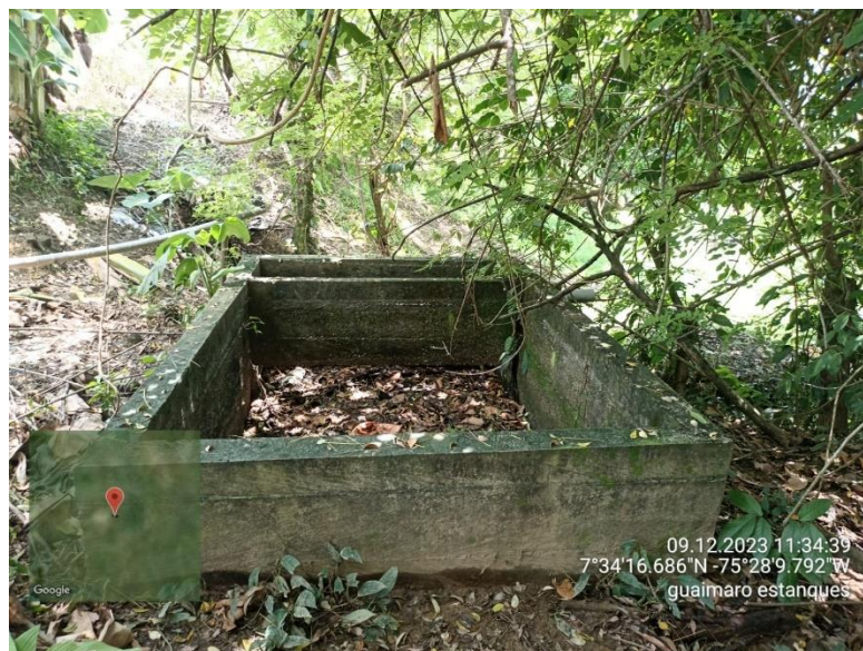
Foto 25. Sistema de tratamiento de Aguas residuales.
