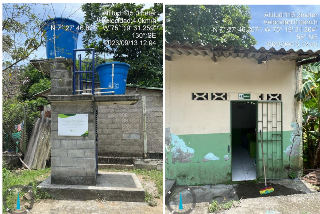
Foto 11. Usos del recurso: Sistema de potabilización y unidades sanitarias.
