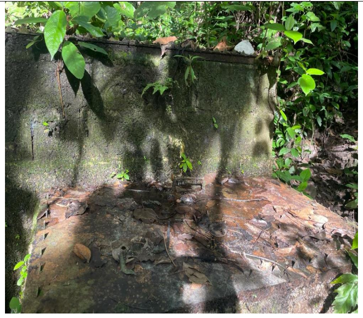
Foto 15. Obra de control y distribución del expediente HX1-2015-133. Donde llega la manguera desde la captación y distribuye a los usuarios Samuel Arenas Garcés y Maria Ximena Sáenz Ramírez. 6°34'53.74" N / 75°50'50.20" W
