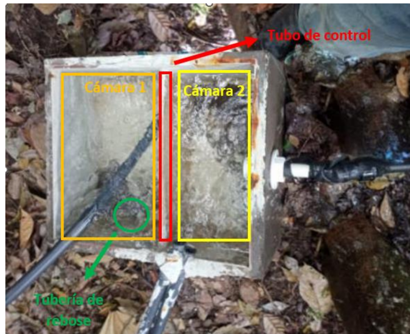
Fotografía 11. Elementos faltantes en la obra de control y reparto
