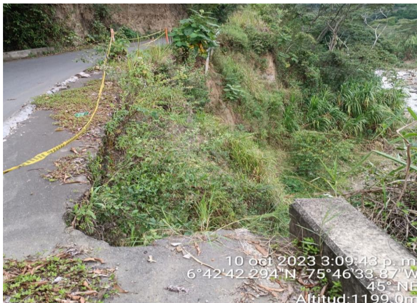
Figura 4. Perdida de banca en la vía que conduce del casco urbano de Liborina al corregimiento de San Diego
