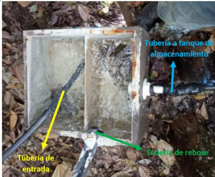
Fotografía 10. Elementos presentes en la obra de control y reparto
