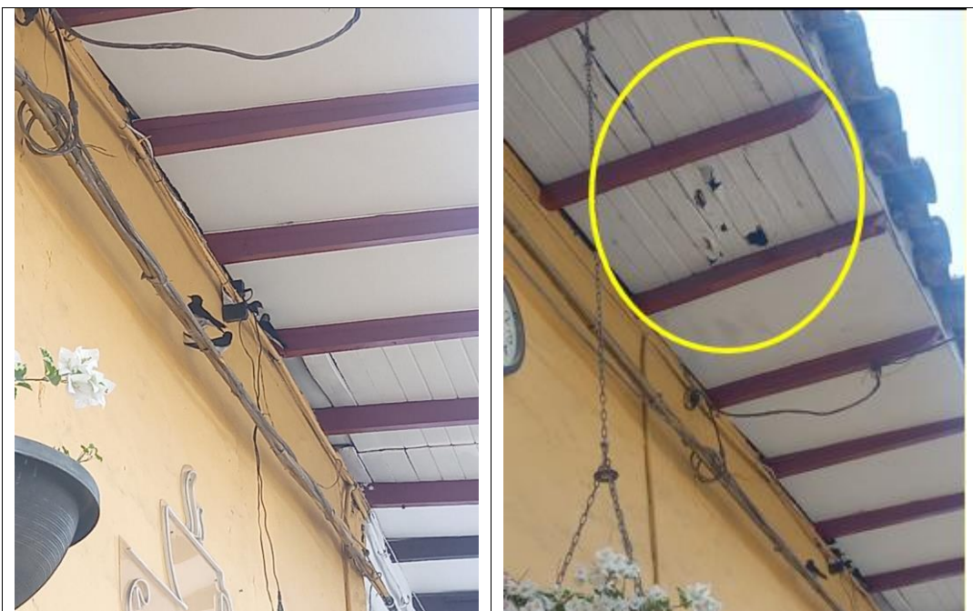
Fotografías 12 y 13. Golondrinas, afectación de techo y posible lugar para anidamiento de aves.
