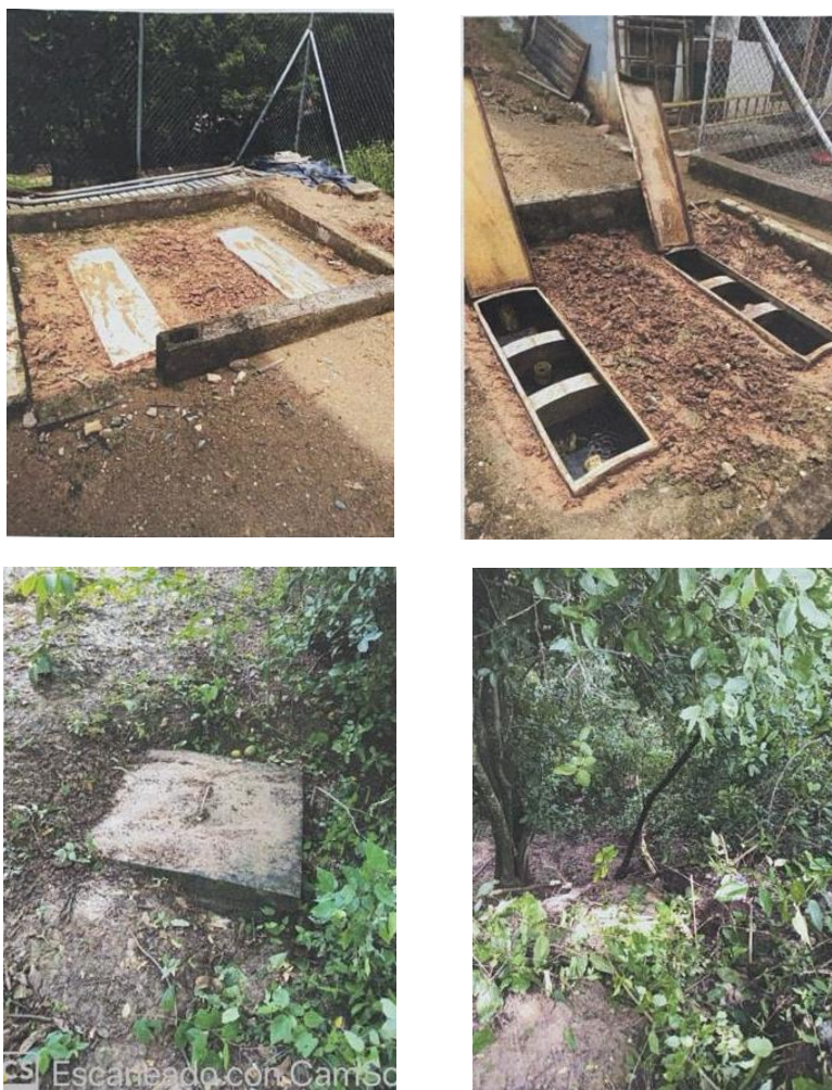
Fotografía 40-44: Sistema Tratamiento Aguas Residuales Domésticas Fuente: COE 160HX-COE2305-22198 del 31/05/2023
