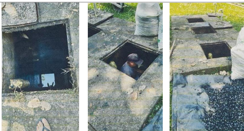
Fotografía 45-47: Sistema Tratamiento Aguas Residuales Domésticas Fuente: COE 160HX-COE2302-8308 del 24/02/2023
