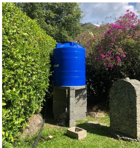
Fotografía 66-68: Obra de control y reparto – tanque de almacenamiento Fuente: COE 160HX-COE2310-41385 del 04 de octubre de 2023
