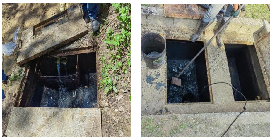
Fotografía 14-15: Sistemas de tratamiento de ARD - ARnD.
