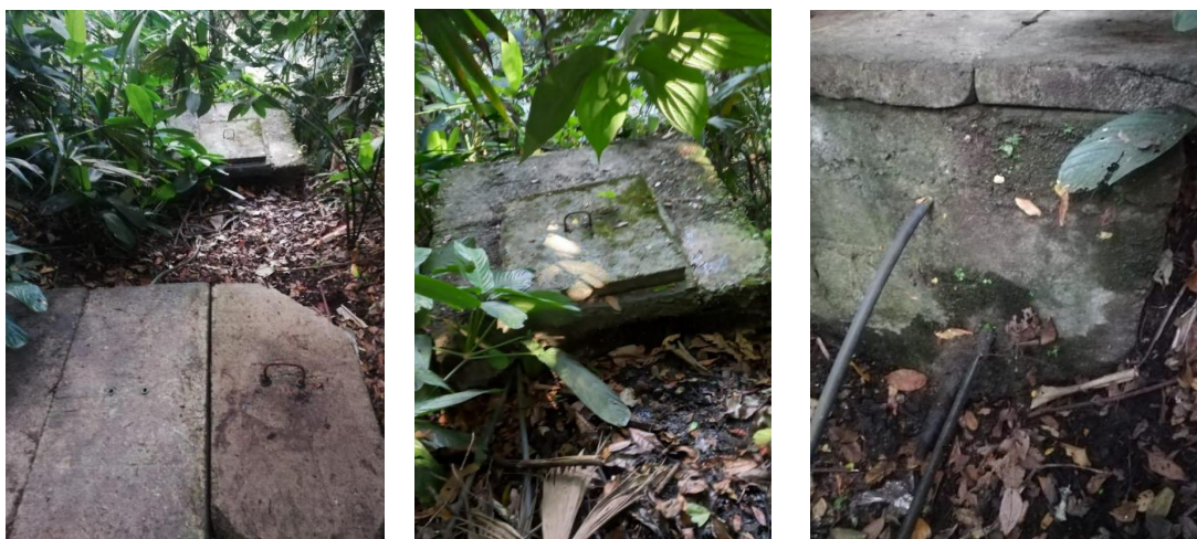
Fotografía 63-65: Tanques de Captación Fuente: COE 160HX-COE2201-2350 del 25/01/2022
