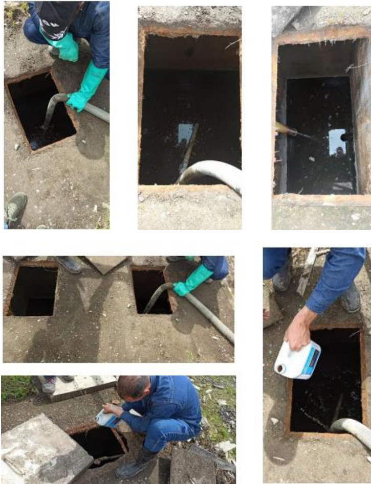
Fotografía 48-56: Sistema Tratamiento Aguas Residuales Domésticas Fuente: COE 160HX-COE2305-18553 del 08/05/2023
