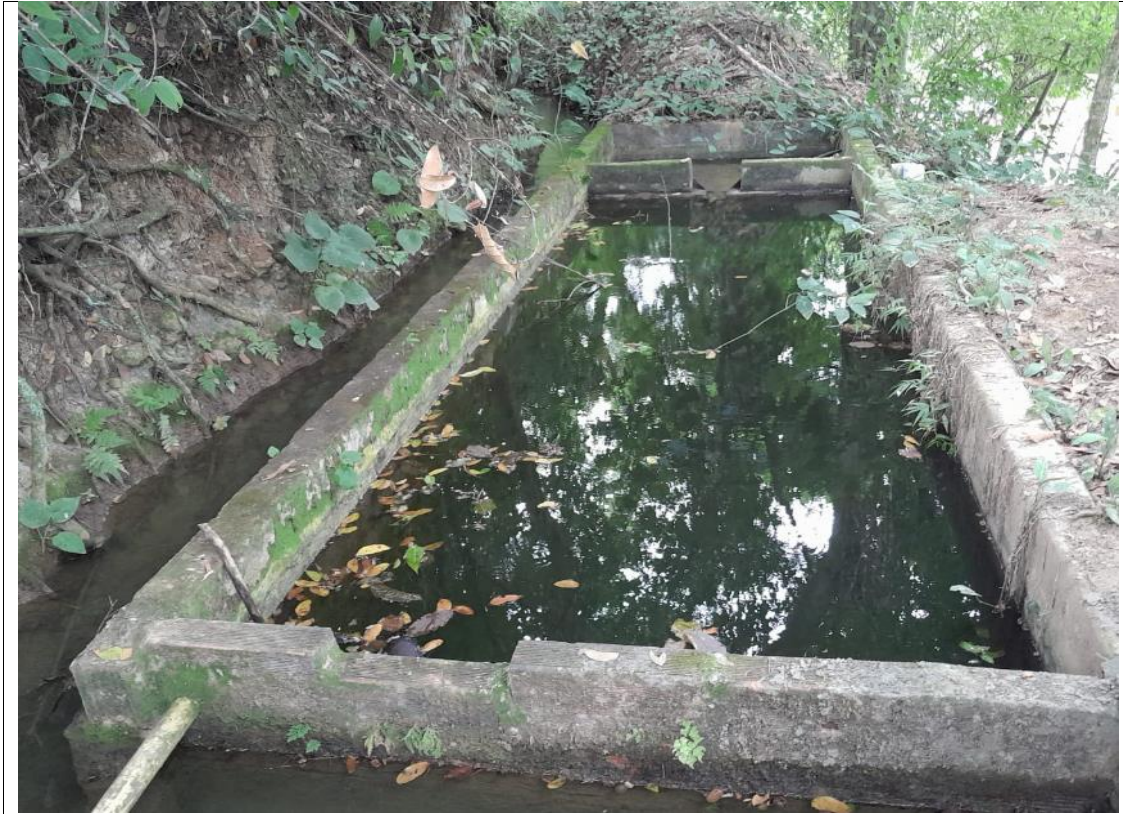
Fotografía 17. Tanque de almacenamiento y reparto. Fuente: Corantioquia 2023
