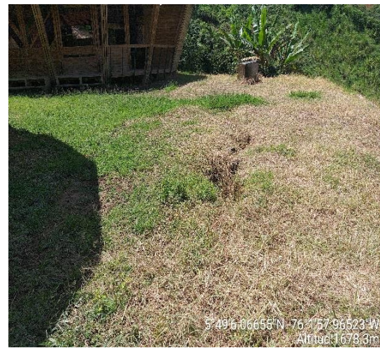
Foto 7. Fisura generada en el lleno realizado para la construcción de la escuela, que genera inestabilidades.
