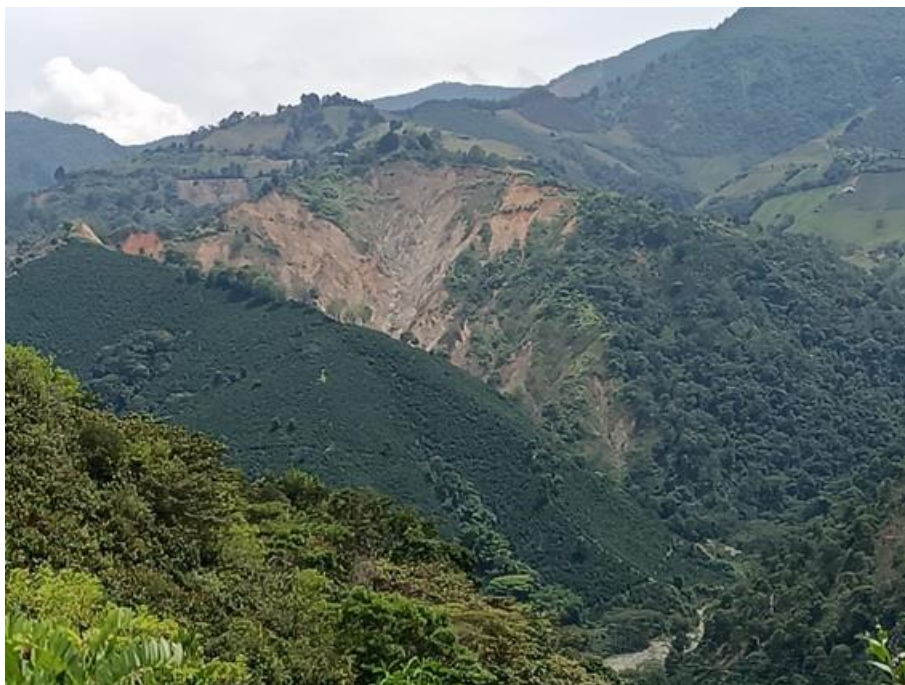
Foto 3. Proceso erosivo sobre uno de los afluentes de la quebrada La Máquina, ubicación 5^{\circ}56'30.61''N 75^{\circ}37'39.79''O , cota 1706 m.s.n.m.
