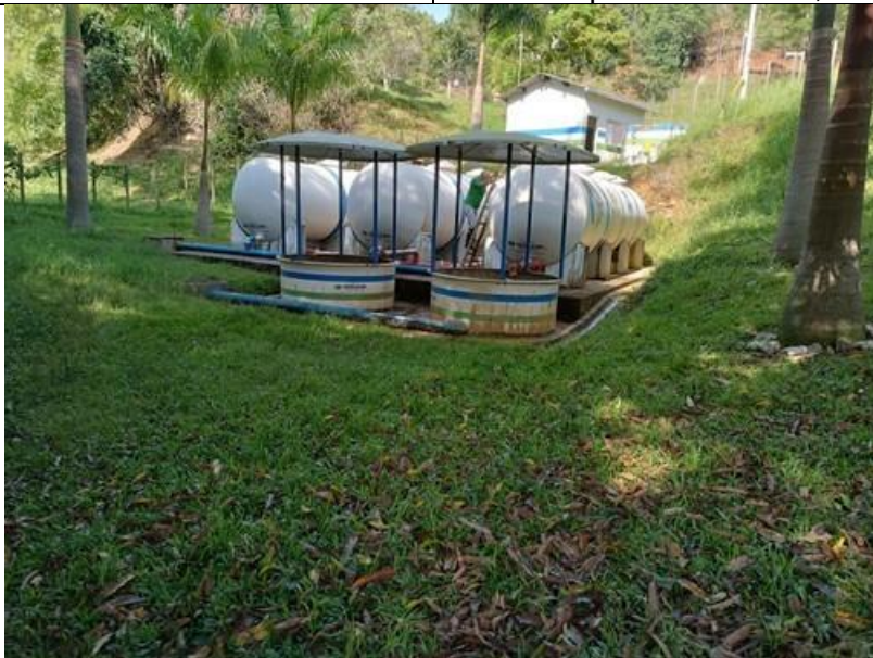
PTARD del corregimiento de Damasco.
