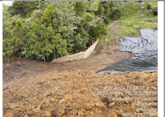
Fotografía 4, Medidas de manejo en adecuación de terreno para siembra de Aguacate Hass, municipio de Caramanta.
