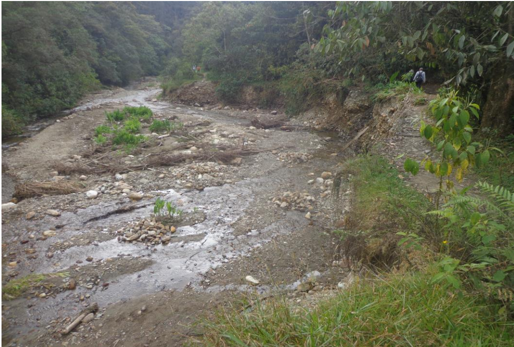
Foto No 05: Talud vertical margen derecha del río con fuertes procesos de erosión y socavación con pérdida de banca
