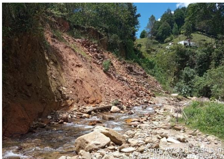
Foto 23, Talud margen derecha quebrada con graves problemas de estabilidad y deslizamientos
