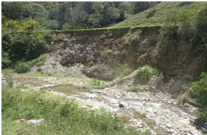
Fotografía 20, Talud margen derecha quebrada con graves problemas de estabilidad y deslizamientos
