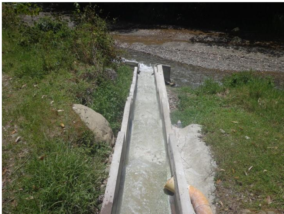
Fotografía 34, Canal En Concreto Descarga Vertimientos PTAR Planta de Alimentos FRIKO
