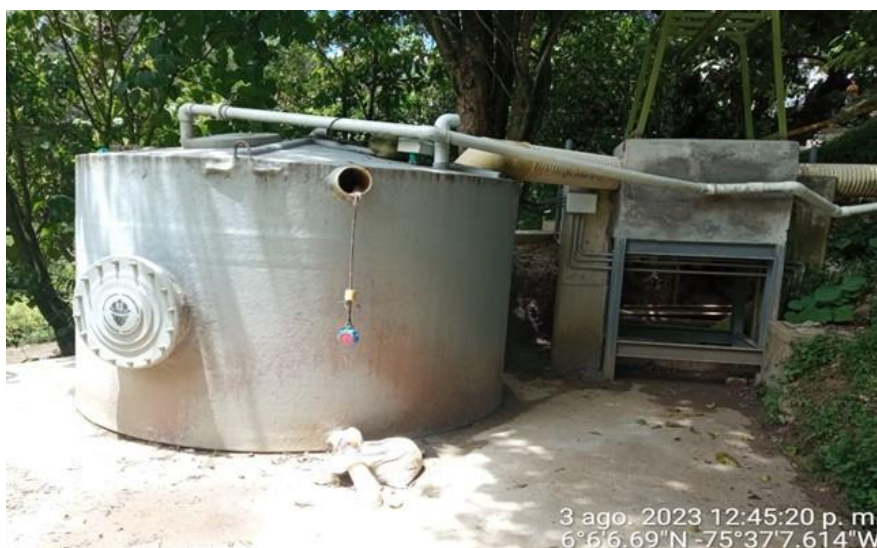
Fotografía 32, PTAR Planta de Alimentos FRIKO Ocupando Franja Retiro Quebrada La Miel
