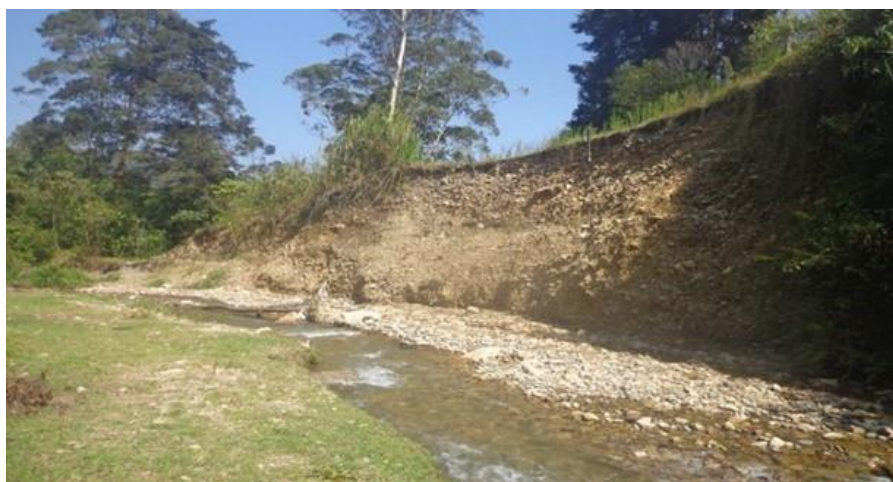
Fotografía 28, Talud margen derecha quebrada con graves problemas de estabilidad y deslizamientos
