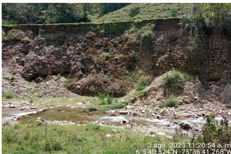
Fotografía 21, Talud margen derecha quebrada con graves problemas de estabilidad y deslizamientos
