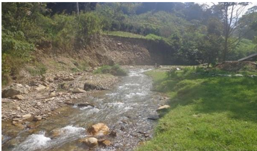
Fotografía 27, Talud margen derecha quebrada con graves problemas de estabilidad y deslizamientos
