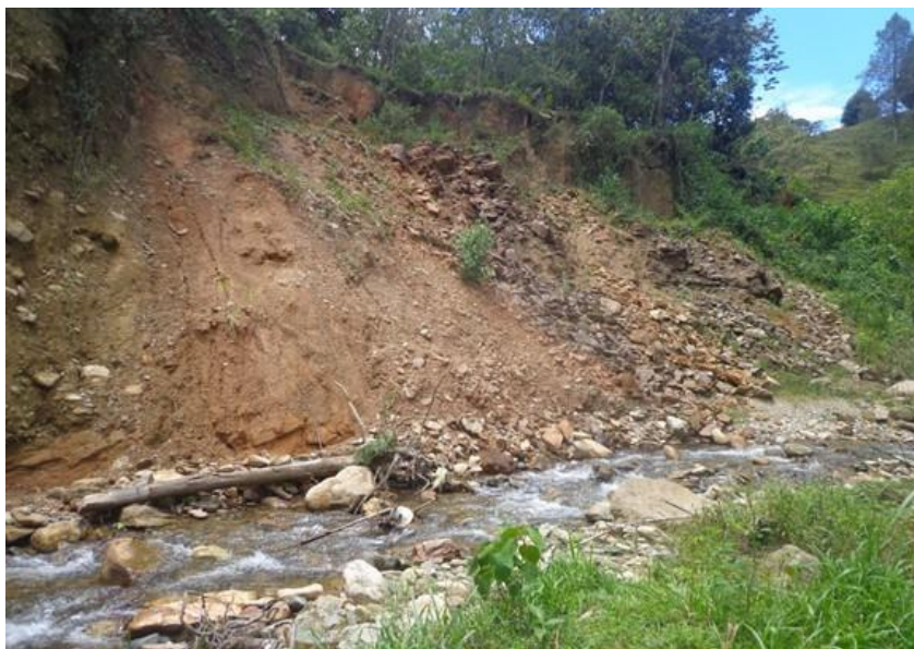
Fotografía 22, Talud margen derecha quebrada con graves problemas de estabilidad y deslizamientos
