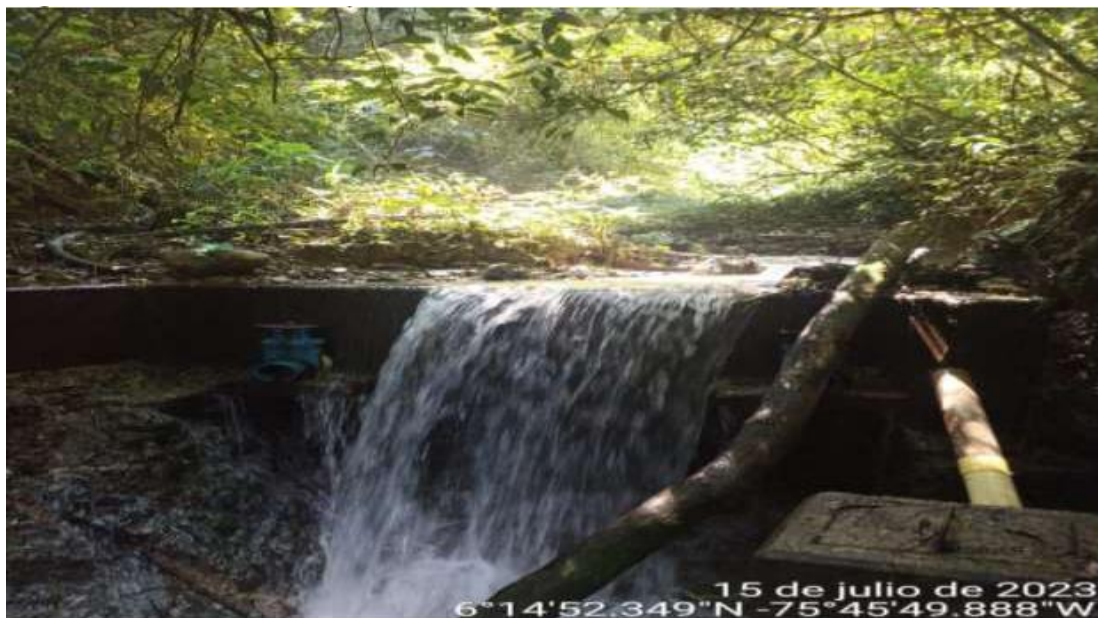
Captación del acueducto del Alto del corral en la Q. La Sucia
