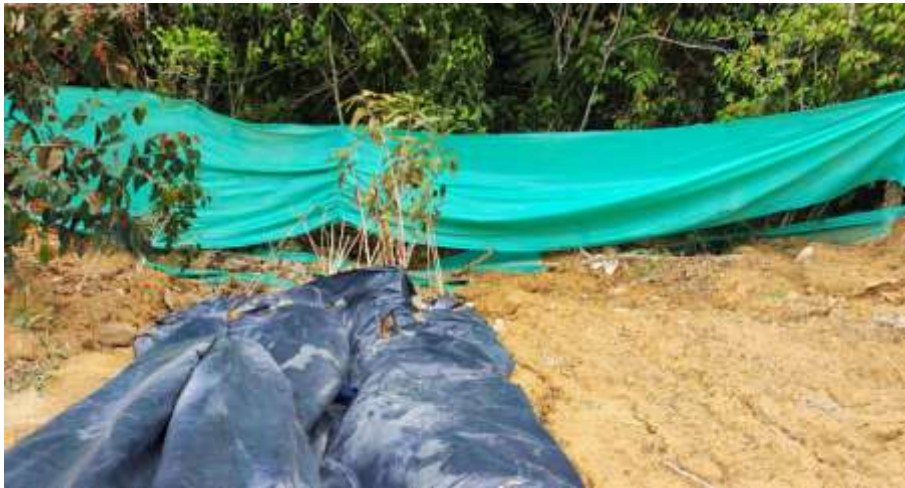
Foto 5: Cunetas revestida de plástico para aguas lluvias de la vía interna de la parcelación Las Margaritas.
