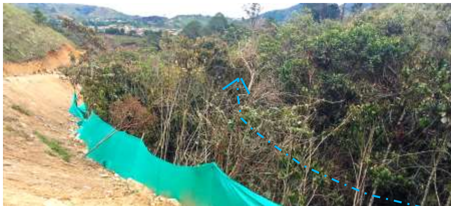
Foto 3: Inclinación del sarán verde con el material de corte para la apertura de la vía interna en la parcelación.
