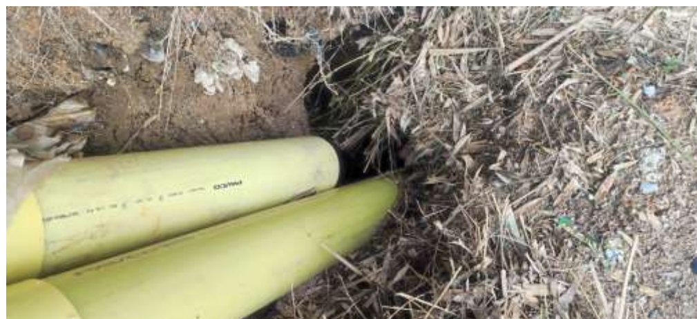
Foto 13: Descarga final de las dos tuberías de PVC sin obra de entrega generando un socavamiento en el talud posterior del lavadero de carros.
