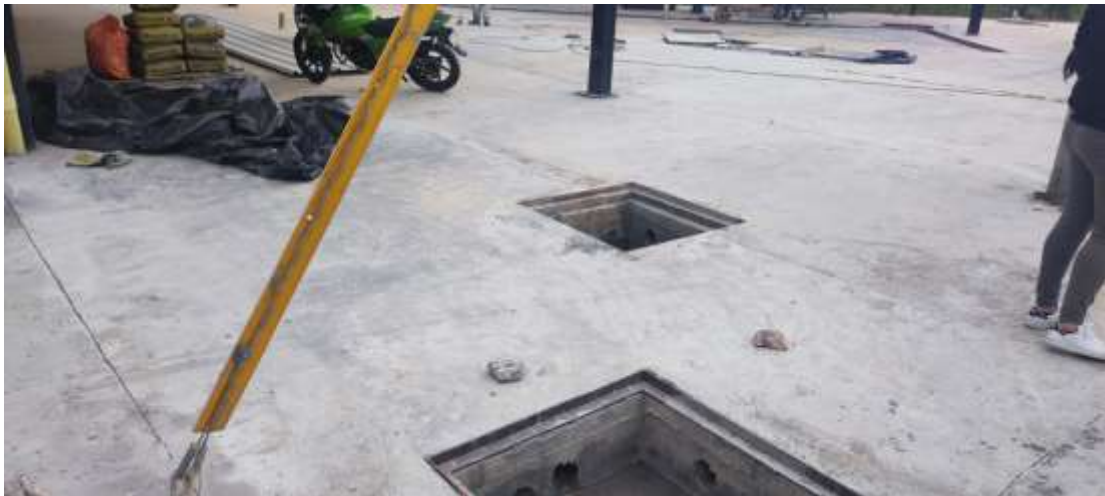
Foto 5: Cajas de inspección, con dirección hacia el alcantarillado municipal.
