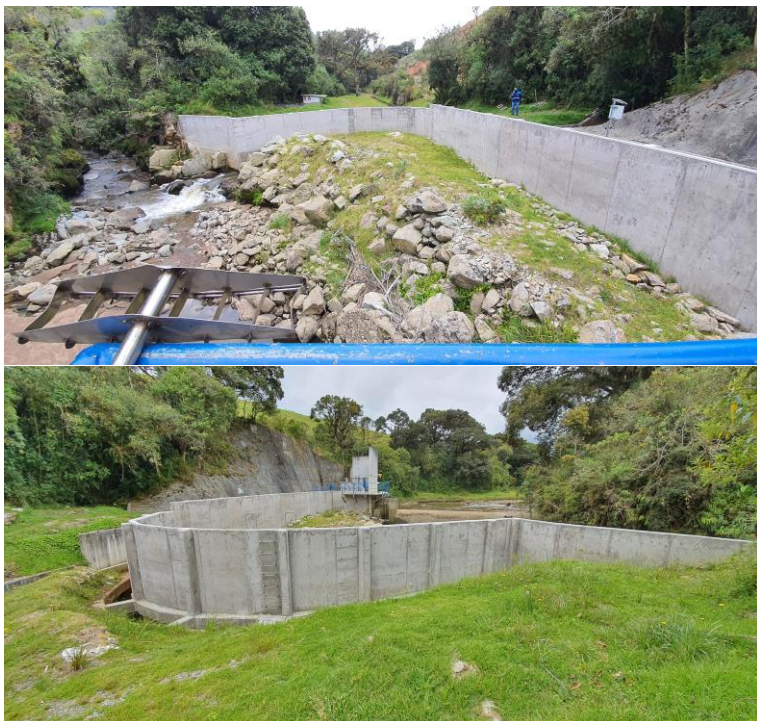
Fotos 4 y 5. Sector de captación. En este sitio se observan las obras construidas por la empresa en atención a la contingencia presentada.
