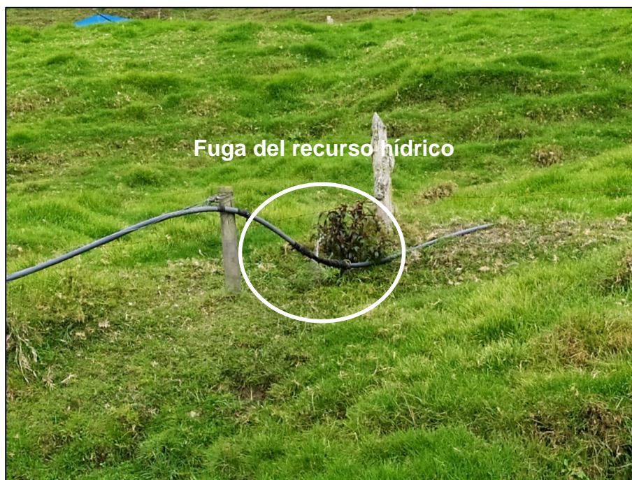
Fotografía 3. Punto de fuga en la tubería
